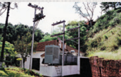
A usina do Rio Palmeira foi reformada em 1956 e em 1993
